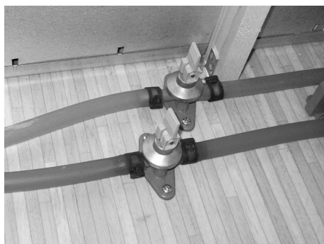
Fig. 104: Vannes de vidange ouvertes
