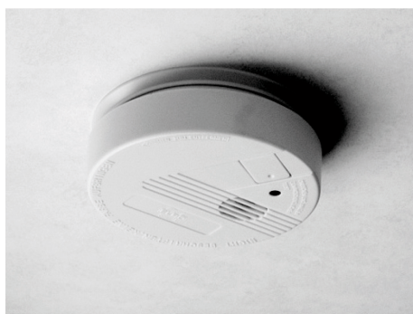
Fig. 43: Détecteur de fumée
