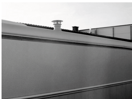
Fig. 84: Conduit d'évacuation des gaz brûlés du chauffage à gaz
